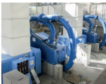
Эл Эден, Колумбия 10,12 МВт; первые две горизонтальные трехлопастные турбины Pelton в Колумбии
